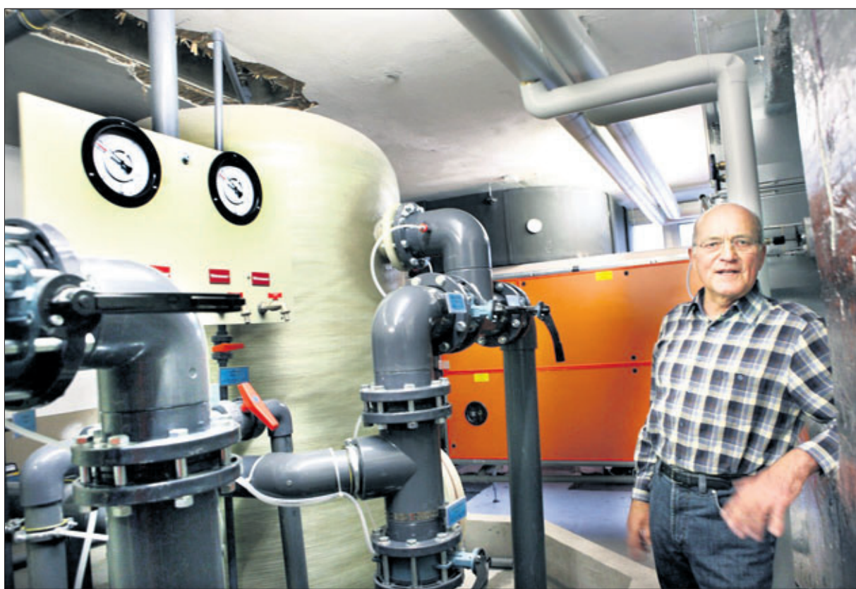
Der Stolz des Strümpfelbacher Bädlesvereins und von Paul Halbich, der sich um die Technik kümmert, ist die neue Lüftungsanlage mit Wärmerückgewinnung.
