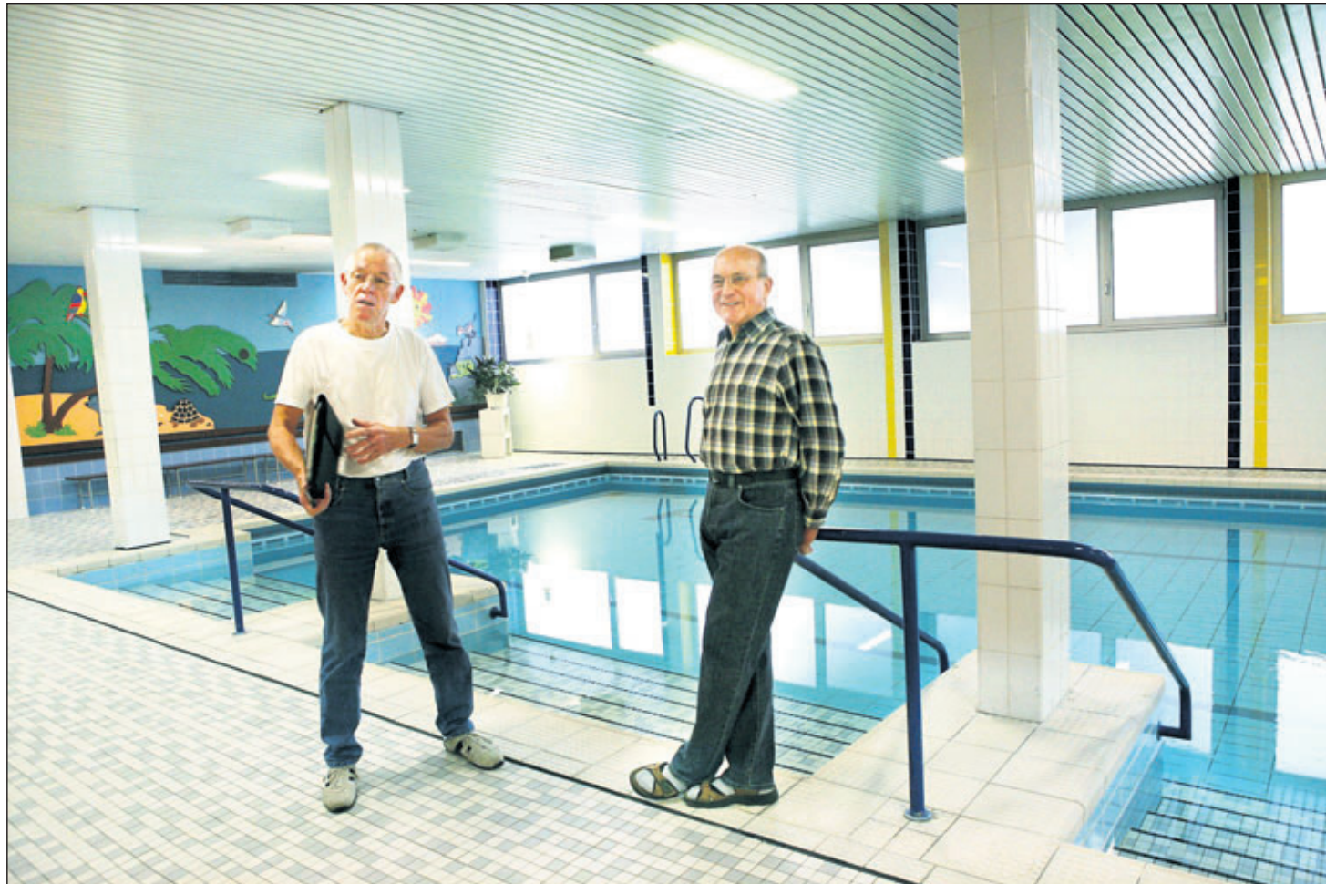
Das Strümpfelbacher Bädle wurde in den Ferien umgebaut, für die Technik zuständig sind Peter-Michael Gotthardt (links) und Paul Halbich.
