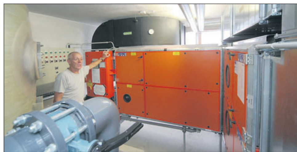
Neueste Errungenschaft: Eine Wärmerückgewinnungsanlage zum Energiesparen.
